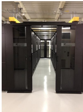
Un couloir de baies de serveurs
