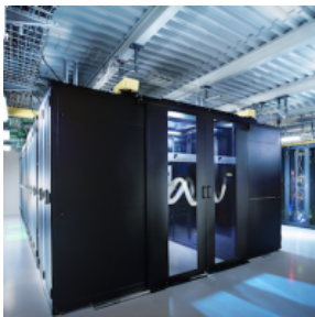
Le futur data center de DCforDATA aura une capacité d'hébergement de 640 baies. Crédit photo : D.R.
